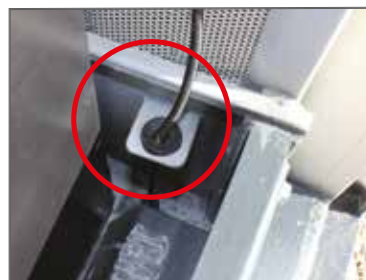
▲ Alarma con tanque de retención
