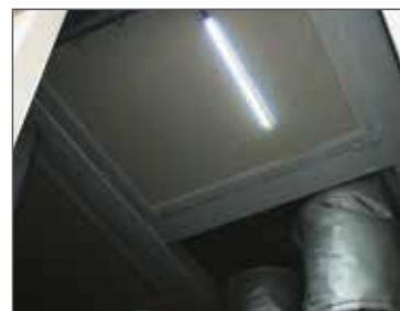
▲ Cerramiento interno con iluminación LED
