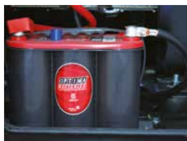
▲ Batería libre de mantenimiento
