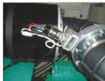
▲ Válvula de cierre eléctrico
